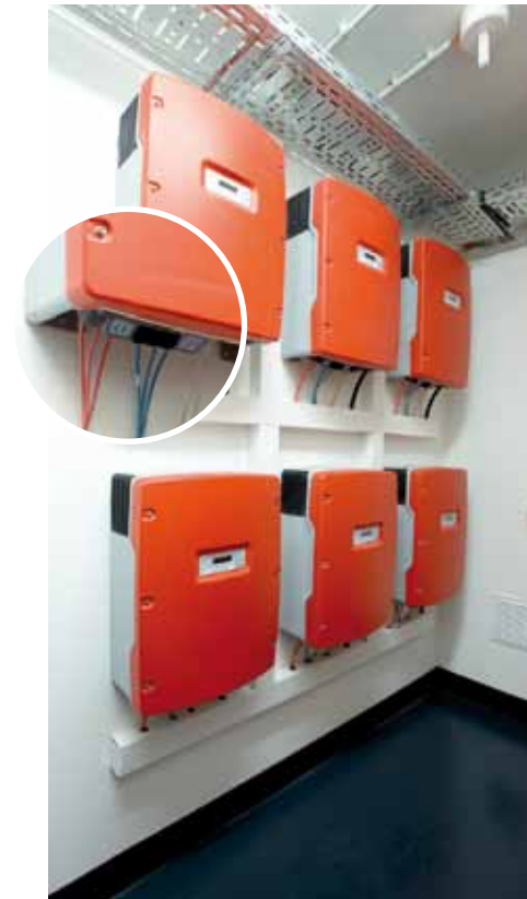
Abb. 19: Wechselrichter können, je nach Gebäudesituation, wie hier im Hausanschlussraum oder aber auch an anderer Stelle installiert sein. Links unten an den Wechselrichtern sind die integrierten DC-Freischnalter zu erkennen.
