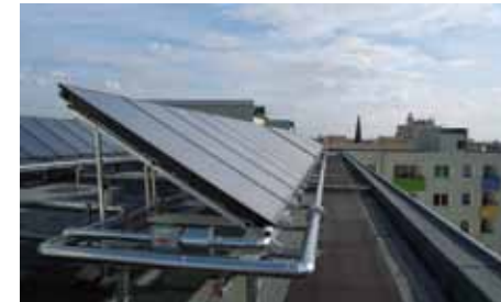
Abb. 4: Solarthermie-Anlage R. Upmann
